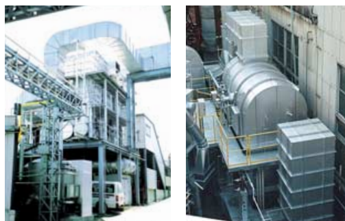
排ガス燃焼処理装置
