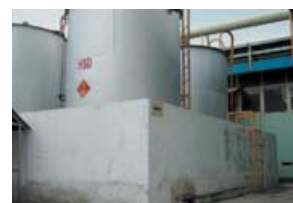
屋外タンクに設置された防油堤
