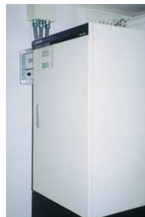
甚目寺工場に設置した窒素リン自動測定装置
