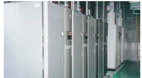
本社・新川工場のカスボイラー
