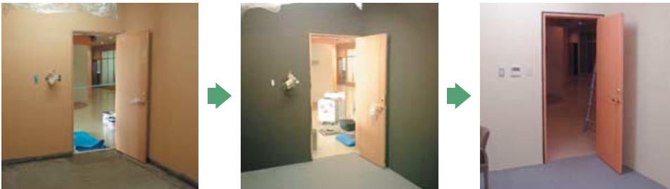
エミシールEM-100施工例(施工前 → エミシール塗布 → シルキーパレットによる最終仕上げ塗装)
