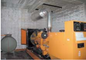
防音処理を行った自家用発電機設置室内
