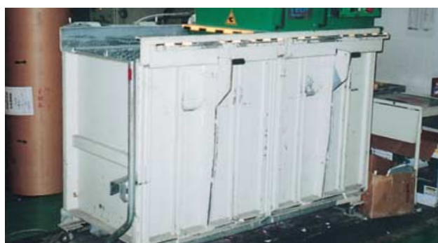
紙類の圧縮回収装置（新川工場）
